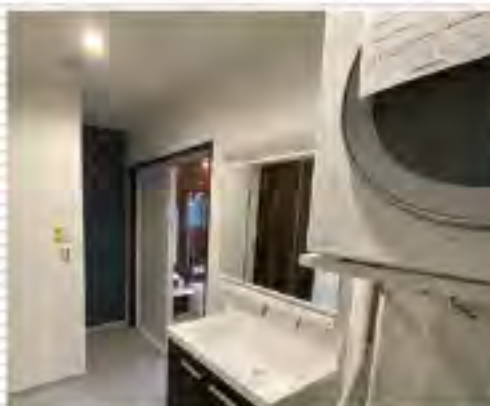
ガス衣類乾燥機 「乾太くん」を設置
